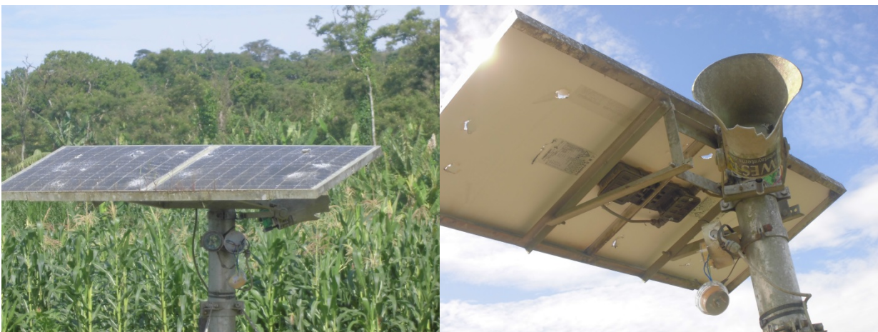
Panneau solaire et système de signalisation détruits à la station d'alarme
