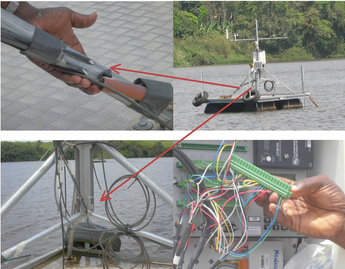
Etat des dégâts a la station climatique
